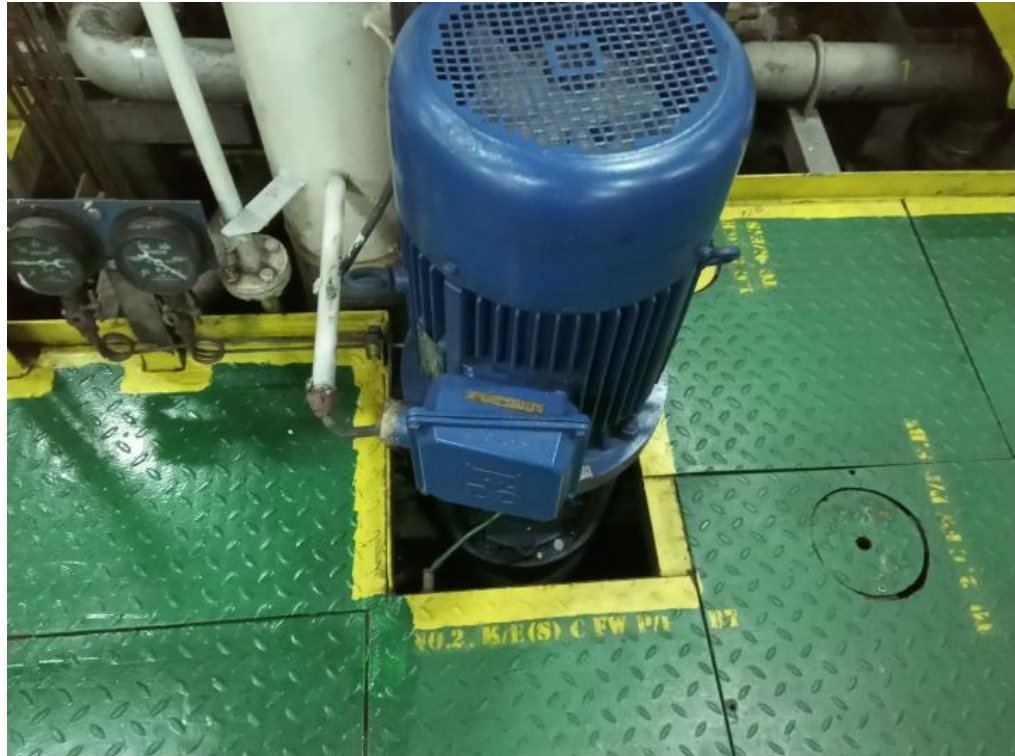
Gambar 2. Pompa Air Laut
