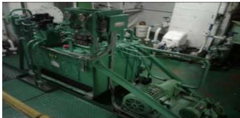
Gambar 9 Konstruksi Hydraulic Power Pack Sumber: Dokumentasi Penulis
