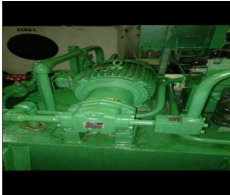
Gambar 8 Lubricating Oil (LO) Pump Sumber: Dokumentasi penulis
