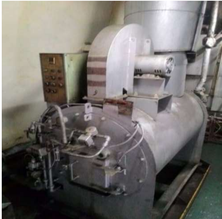
Gambar 2.2 Mesin Incenerator di MV.Selat Mas
