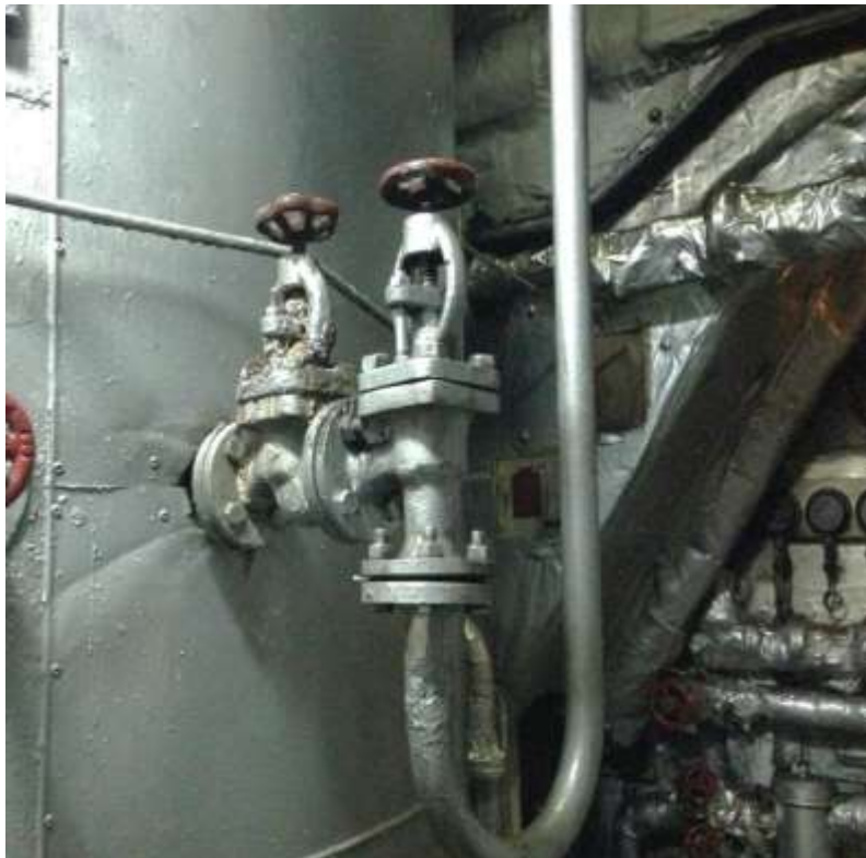
Gambar 2.12. Katub Pengisian Boiler(MV. Sinar Papua)
