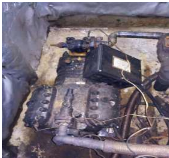
Gambar 2. Kompresor SS BARAKUDA
