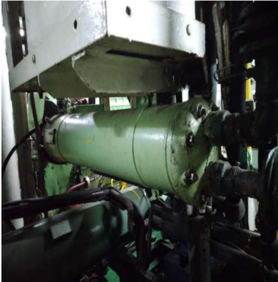
Gambar 3. Kondensor Kapal SS BARAKUDA
