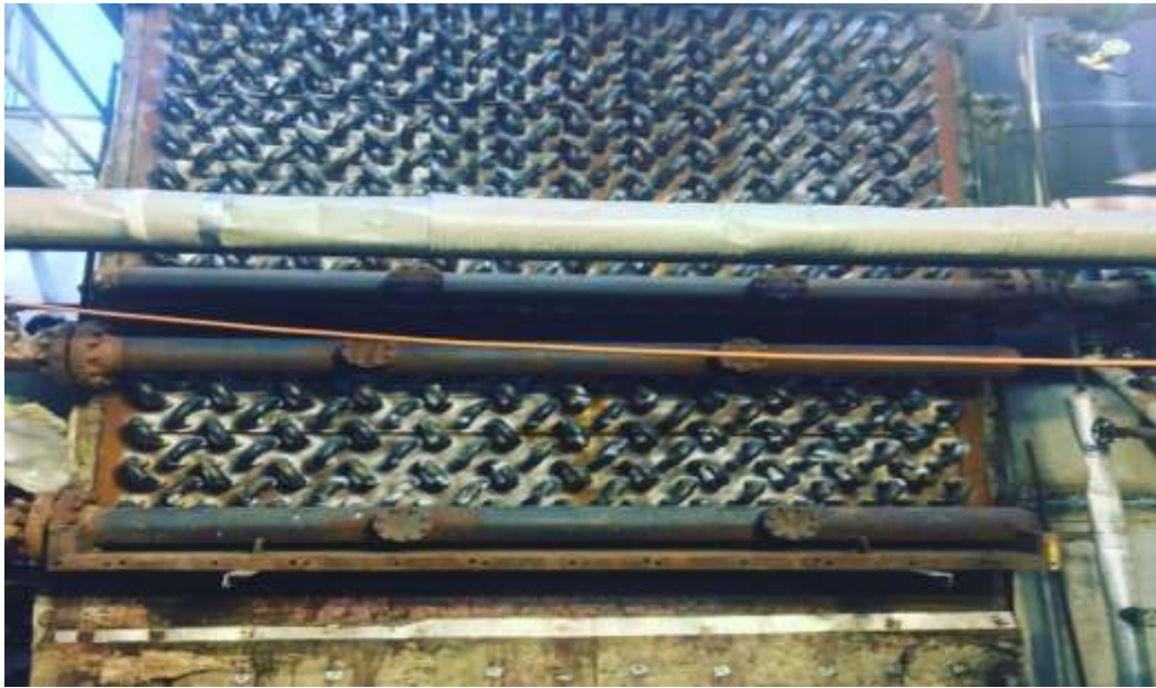
Gambar 1. Pipa inlet dan casing ekonomiser.
