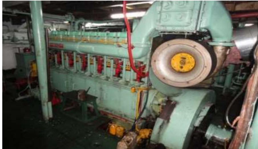
Gambar 1. Generator (Sumber : KM. SINAR BANGUN)
