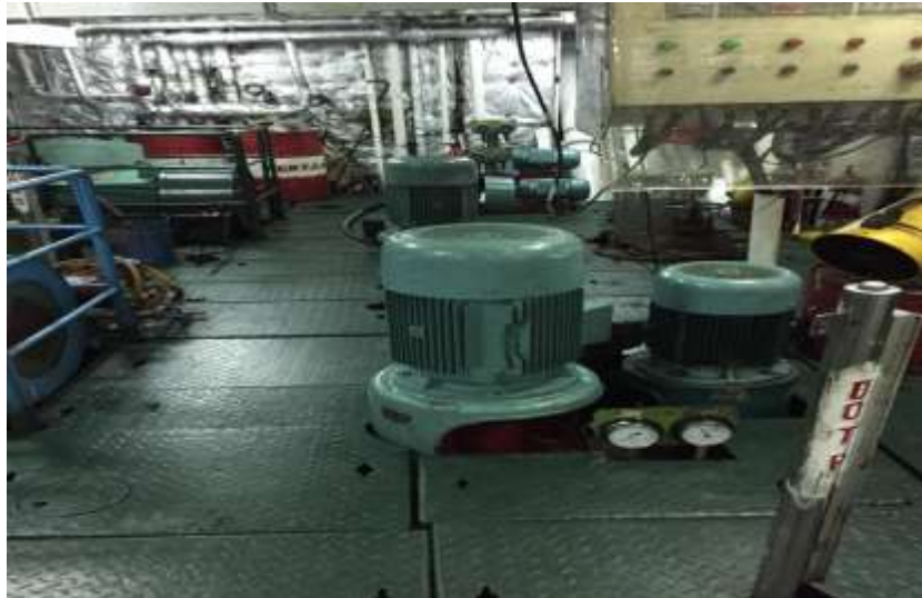
Gambar 2.1 Pompa Sentrifugal Sumber Dukumen Pribadi 2018
