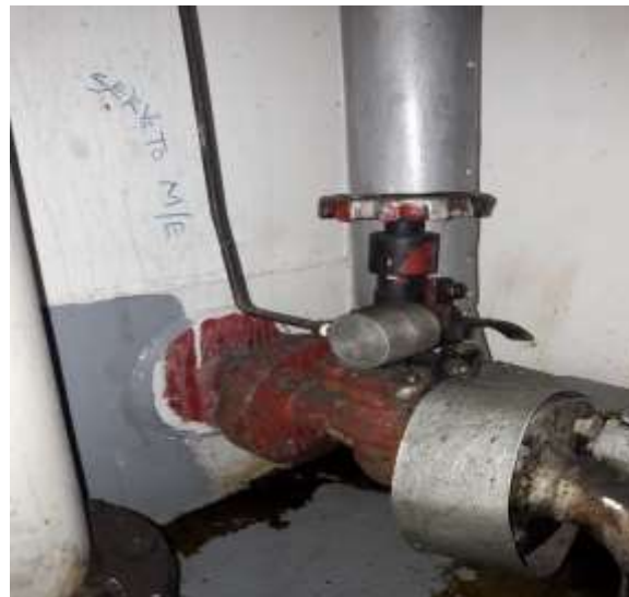
Gambar 2.5 M.F.O service tank quick closing valve ( Sumber: Dokumentasi penulis )
