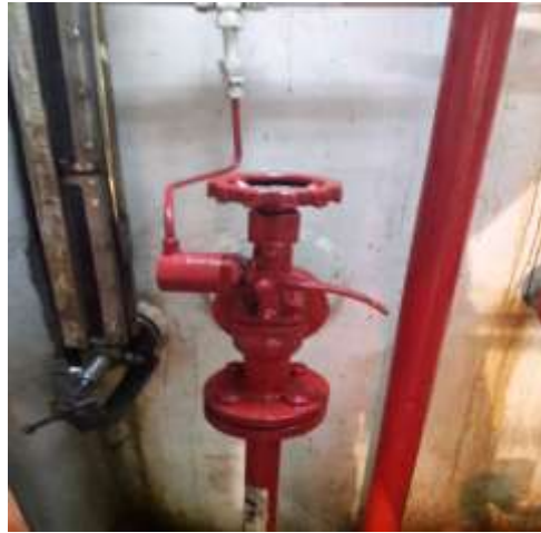
Gambar 2.8 M.D.O settlink tank quick closing valve ( Sumber: Dokumentasi penulis )
