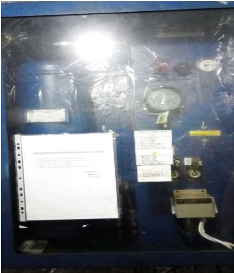
Gambar 2.12 Panel control untuk quick closing valve ( Sumber: Dokumentasi penulis )
