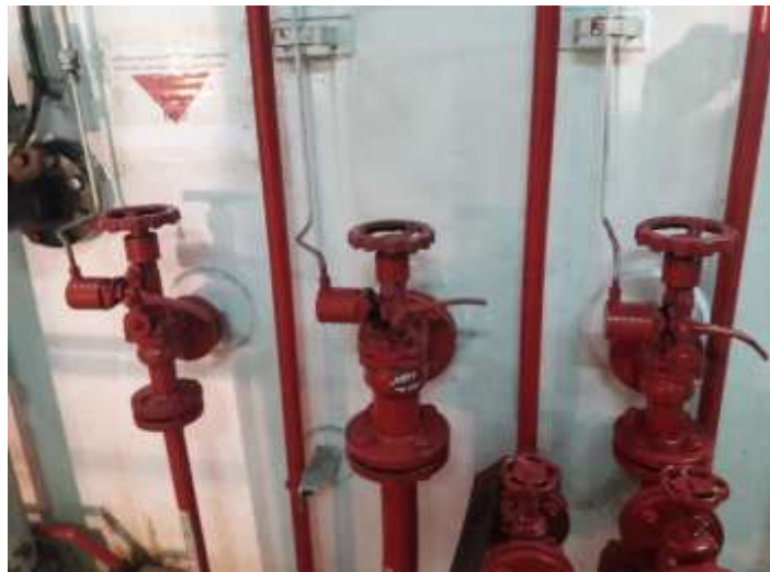
Gambar 2.9 M.D.O service tank quick closing valve ( Sumber: Dokumentasi penulis )
